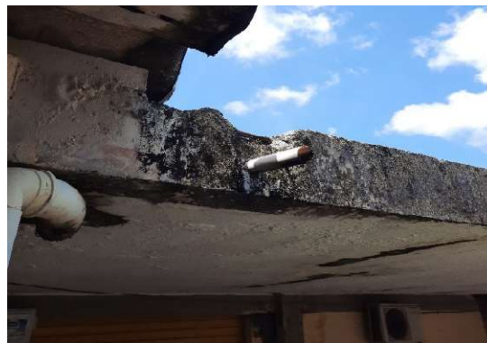
Figura 7: Perda de seção em laje.
