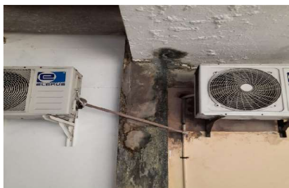
Figura 9: Infiltrações ao longo do pilar e laje.
