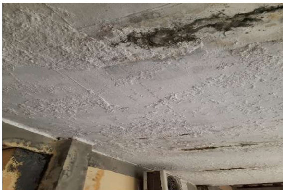
Figura 10: Infiltração em laje.
