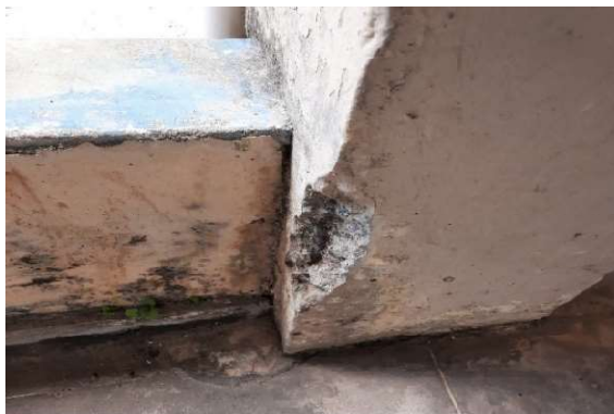
Figura 6: Perda de seção em pilar.
