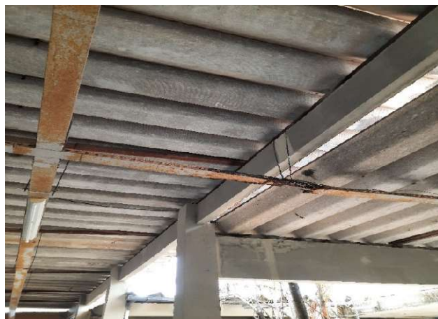
Figura 8: Corrosão de elementos metálicos
