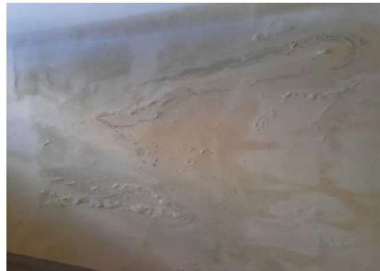
Figura 11: Infiltração ao longo da parede.
