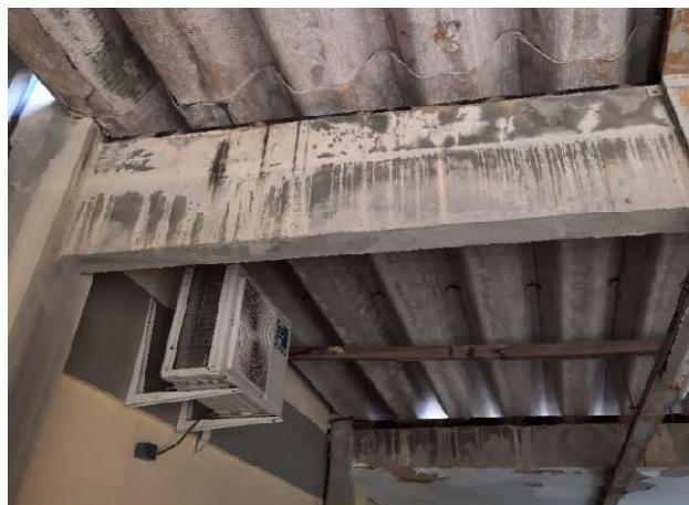
Figura 5: Efeito da carbonatação em viga.
